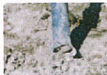
足場管を杭として使用すると、土が入り込んでしまいます。
